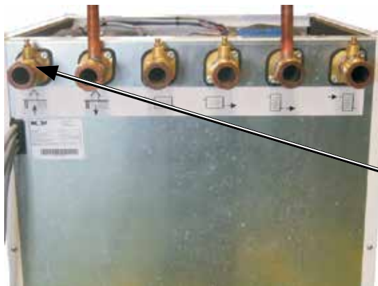
Ręczny odpowietrznik na dopływie solanki
